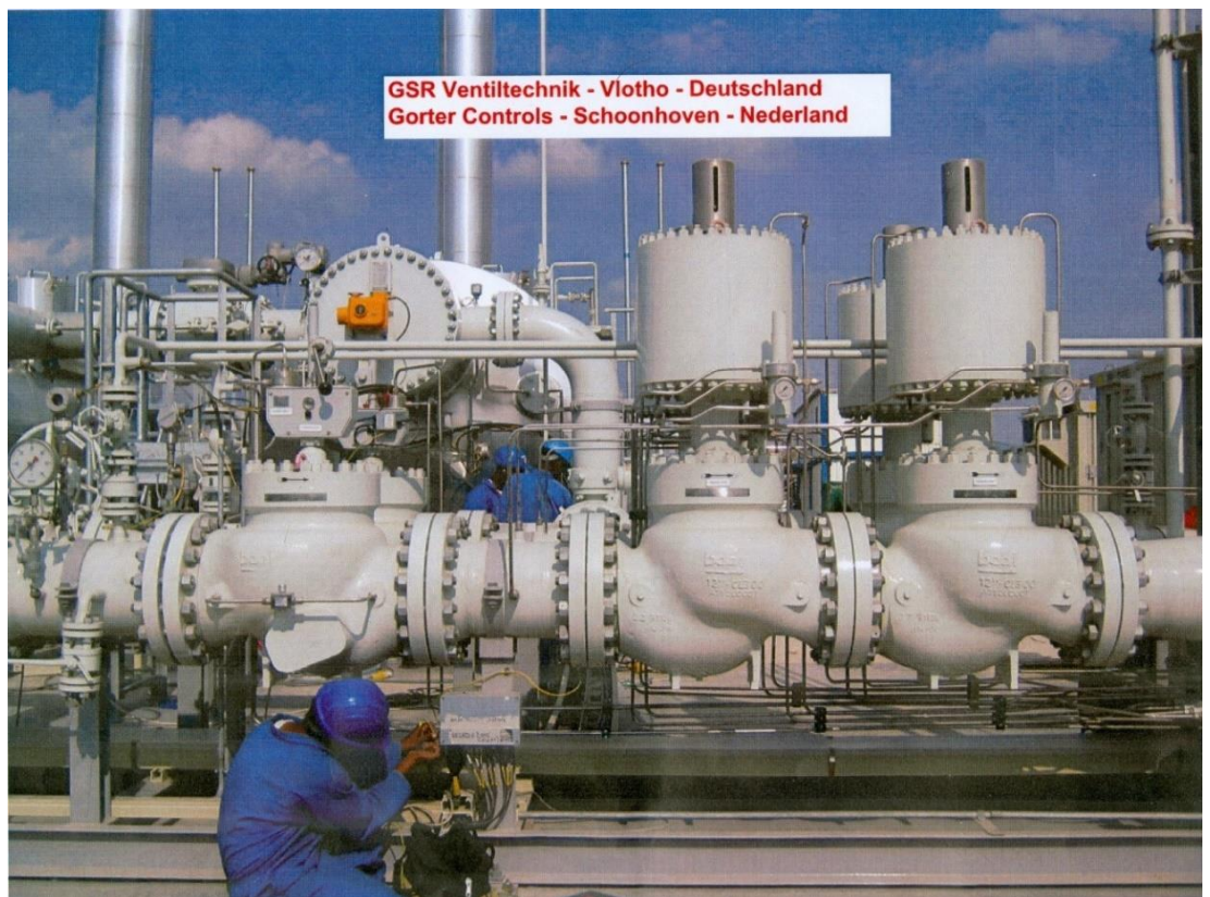
Afb. 10 Grote pompinstallatie voor aardgaswinning
